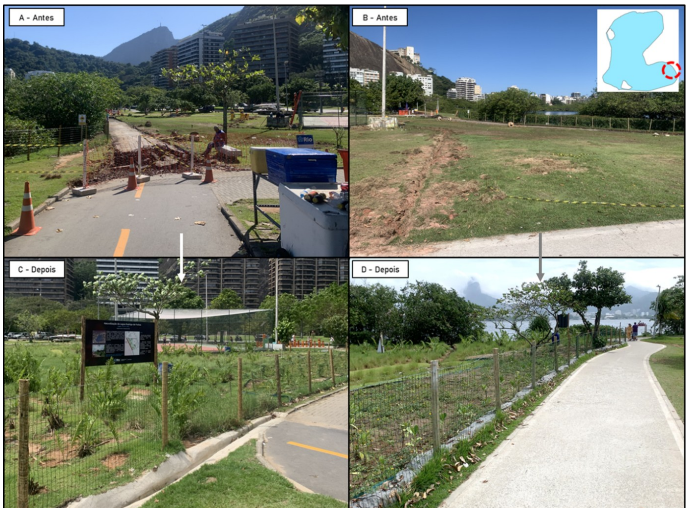
Figura 3. Processos do projeto de renaturalização das margens do Parque do Cantagalo na Lagoa Rodrigo de Freitas: A-B. Início do processo (junho/2023), com destaque para a retirada das interferências urbanas (A) e do preparo do solo para entrada da água lacustre (B); C-D. Processo concluído (outubro/2023), com evidência para proteção por gradeamento, solo preparado e os novas espécies vegetais plantados. A e C: Visão norte-sul; B e D: Visão sul-norte. Fotos: Sabino, H.
